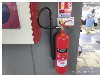
Fire extinguisher (CO2).jpg
